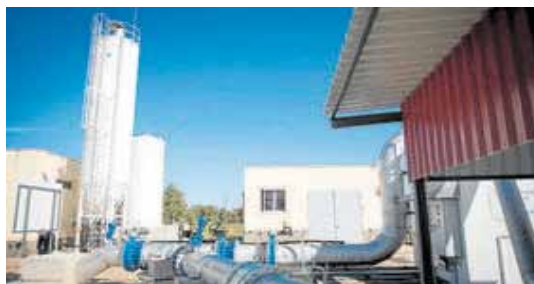
Canalización que llega desde Alange. hoy
