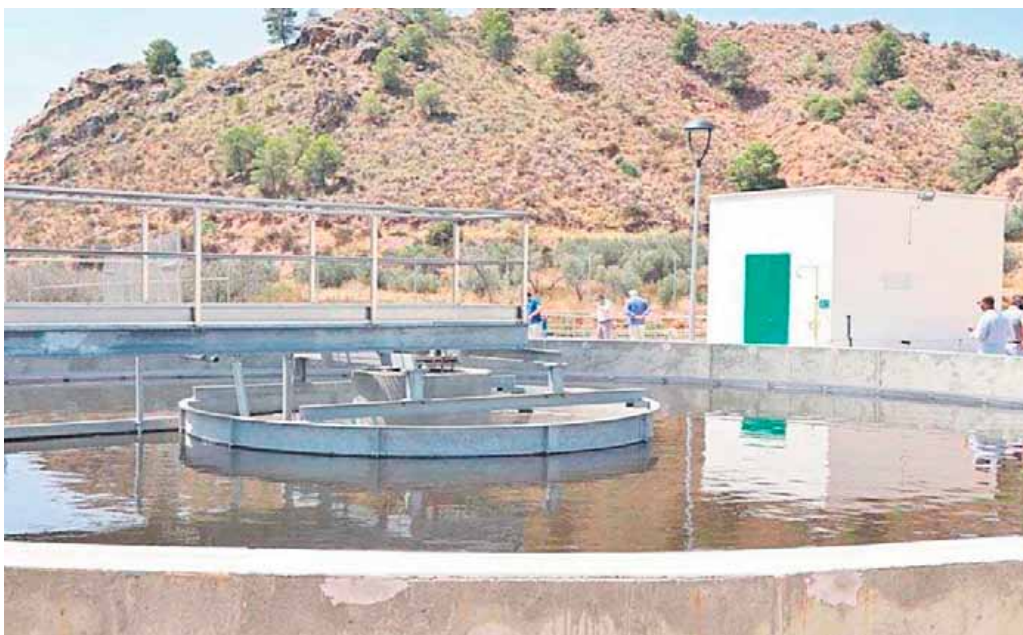
La planta de depuración de aguas residuales del municipio granadino de Benaolúa, una de las señaladas en la última demanda de la Comisión Europea.
